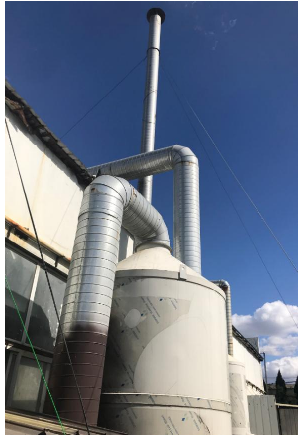
水喷淋+光催化氧化+活性炭吸附+DA002 排气筒
