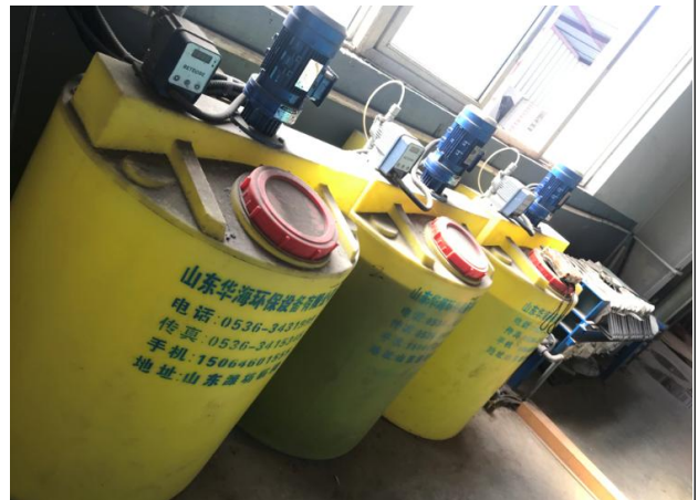
生产废水处理设施
